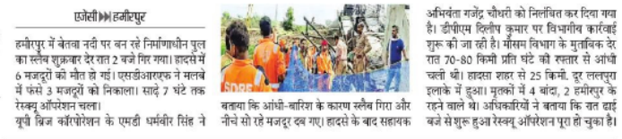
हमीपुर में बनेता नदी पर बन रहे निर्माणधीन पुल का स्लैब गिरा। 6 की मौत, 3 मजदूरों को बचाया
